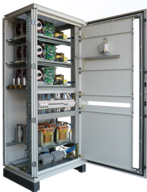
Vstaby EM 80KVA con filtri per riduzione correnti armoniche ed analizzatore di rete
