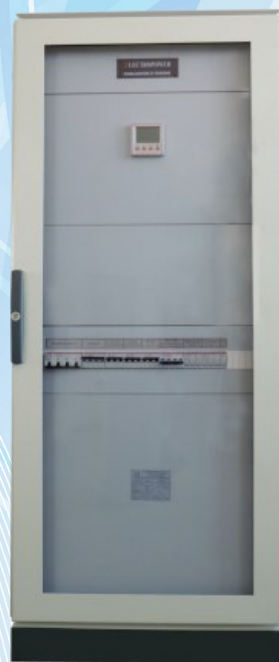
Vstaby EL 60KVA con analizzatore di rete
